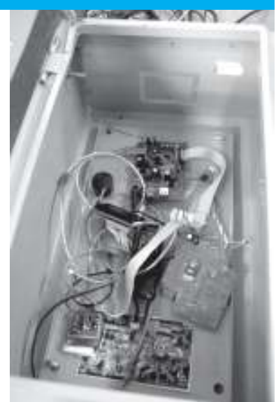
Hệ thống mạch điện bên trong thùng ATM.
